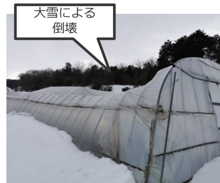
農業用ハウスの補強対策未実施
