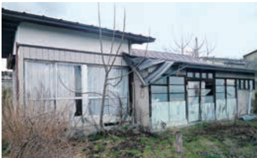
倒壊のおそれのある危険空き家
