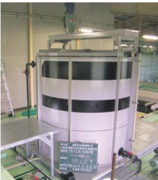
新設された活性炭注入設備
